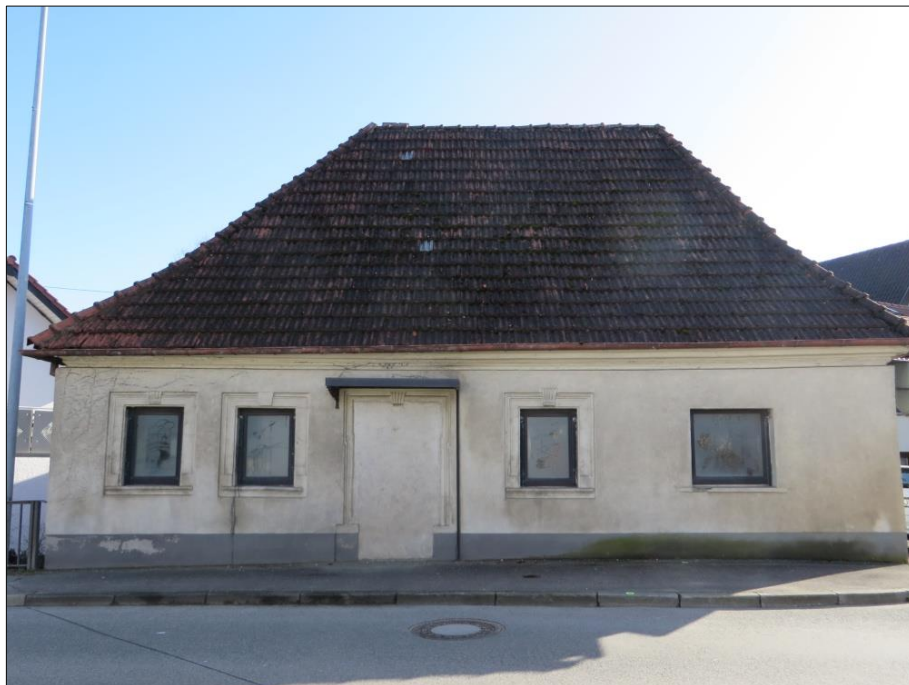
Abbildung 17: Gebäude mit erheblichen Mängeln im Ortskern
